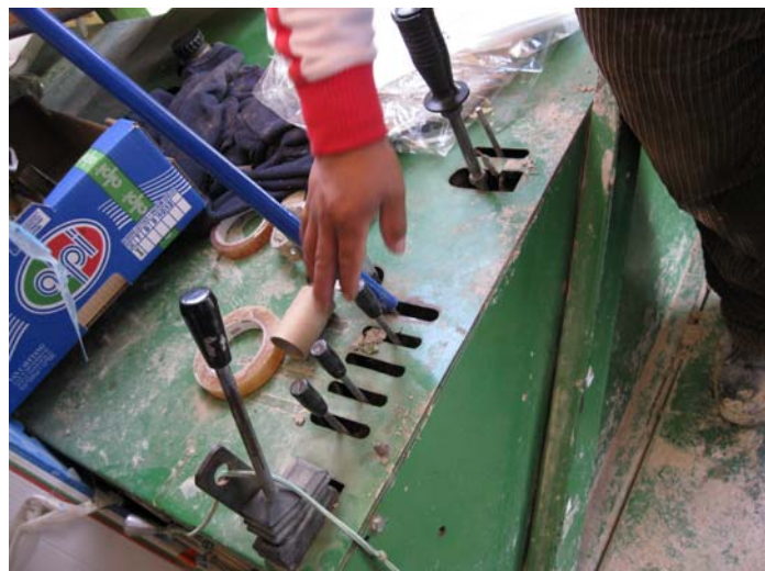
Órganos de accionamiento en condiciones deficientes
