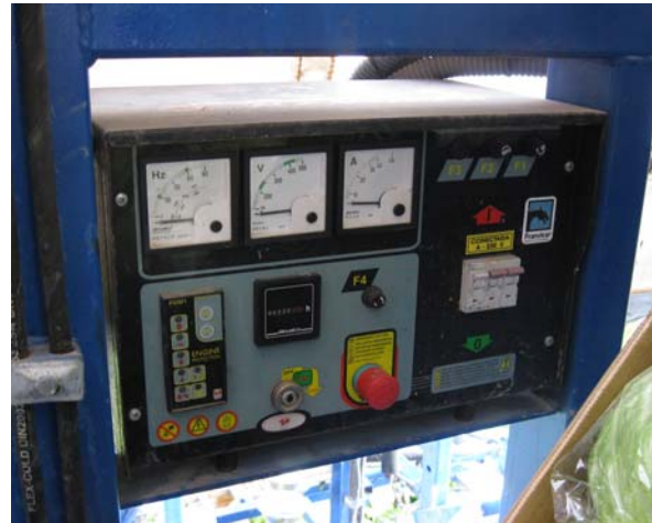
Cuadro de control de un grupo electrógeno
