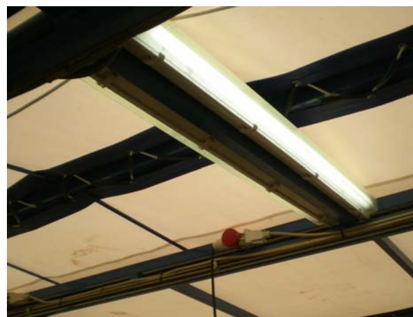
Alumbrado interior de la plataforma
