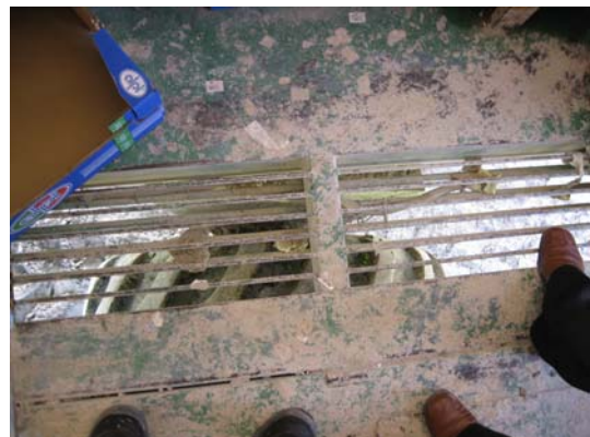
Rejilla en el suelo de la plataforma
